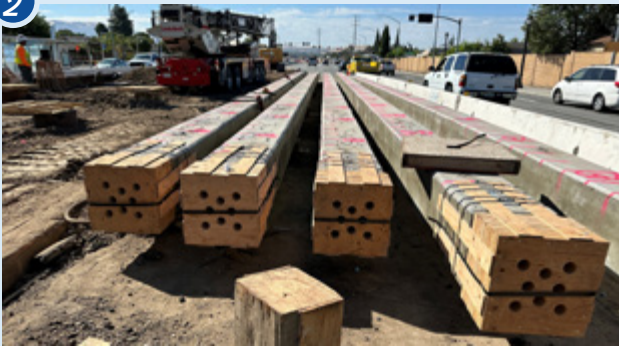
Se colocan pilotes a 80 pies de profundidad que servirán de soporte a las columnas.
