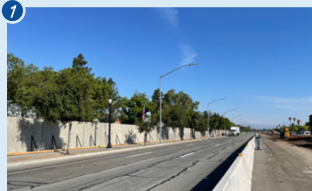
1 Pinalapad ang Capitol Expressway sa mga lugar upang magkaroon ng puwang sa gitna. Kinakailangan ang espasyong ito upang mapabilis ang paggalaw ng heavy equipment na gagamitin para sa paggawa ng pondasyon.
